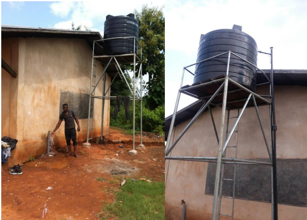
Vue du château d'eau dans le groupe scolaire de Yopé.
